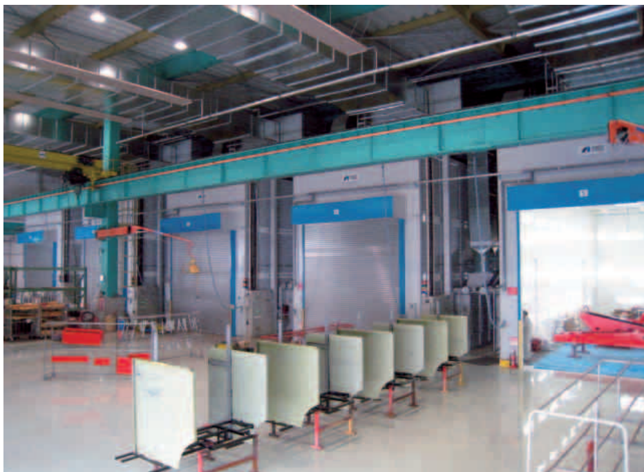
塗装ブースが5台整列した新塗装工場。実に壮観な眺め
