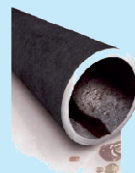
配管と コンプレッサオイル
