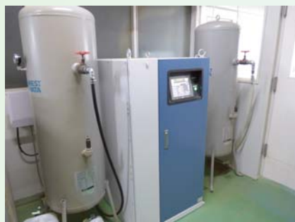
窒素ガス発生装置
